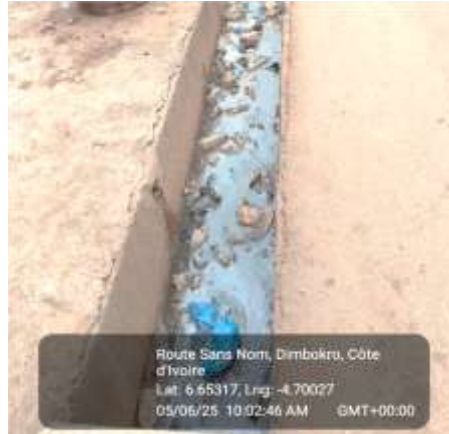
Photo 2 : Caniveau obstrué par les résidus des activités artisanales
