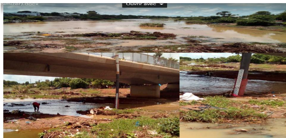
Photo 2 : Accumulation de sédiments provoquant l'ensablement du fleuve au niveau du pont Abdou Diallo, sur la rive droite.
