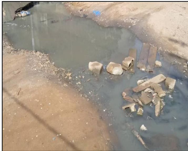
Photo 3 : Ecoulement de l'eau usée sur la route au quartier Sepko
